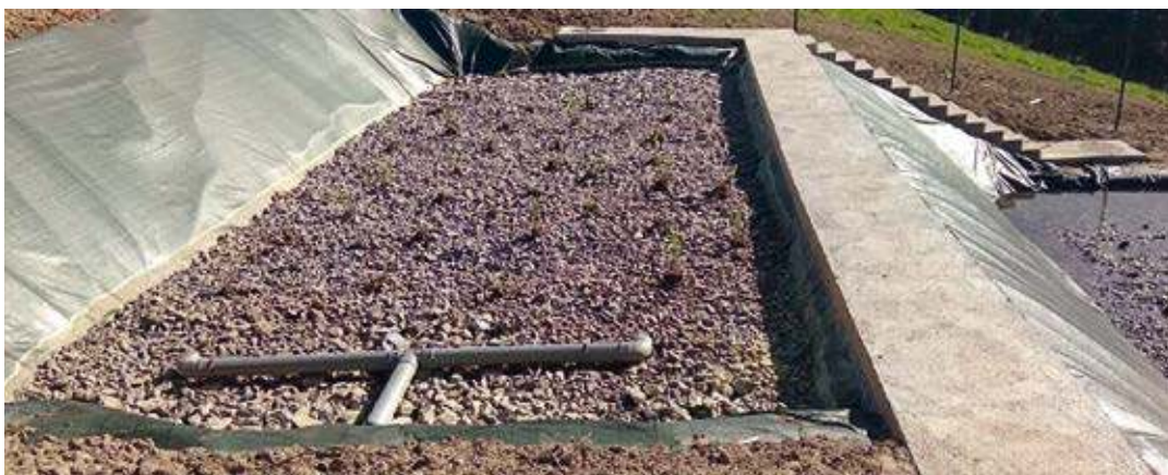
Vaso inferior del humedal ejecutado, en el que se visualiza el sustrato filtrante de grava, de distintas granulometrías, con un espesor de 60 cm, en el que se fija la vegetación acuática.
