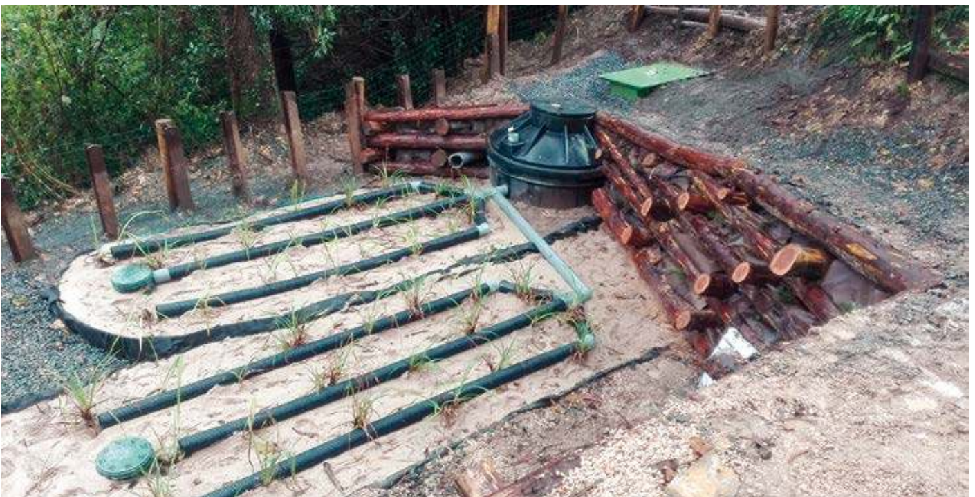
Aspecto general del sistema de fitodepuración y filtración mecánica-biológica tras la finalización de la intervención.
