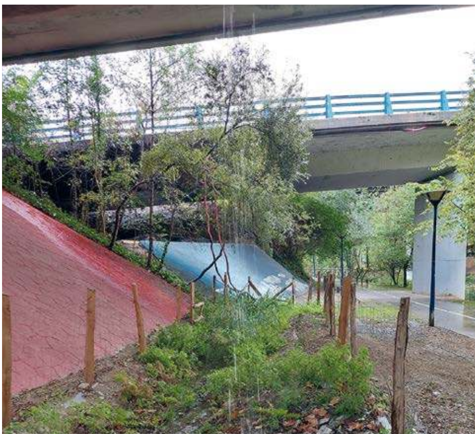
Caída del agua de escorrentía del viaducto de la autopista a la cuneta naturalizada de la parte inferior.
