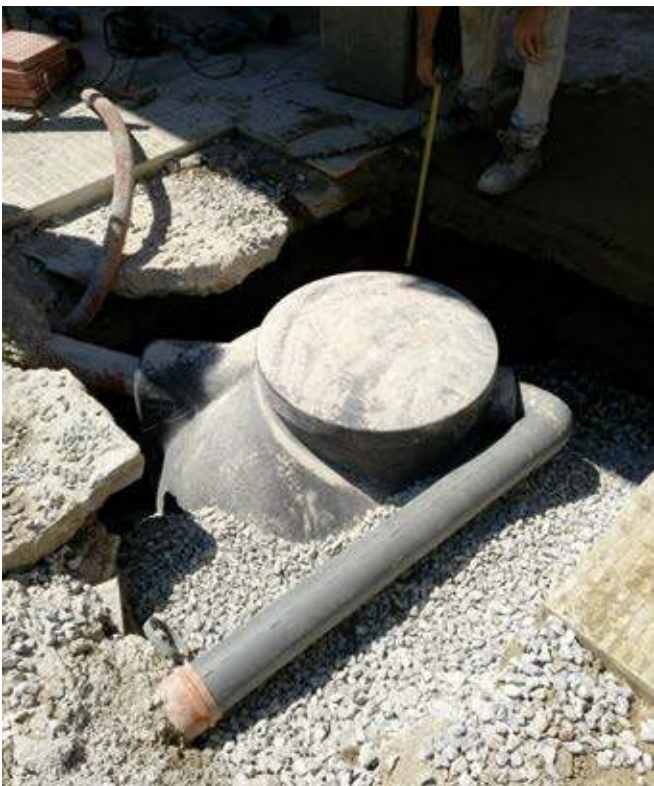
Depósito de retención de agua.
