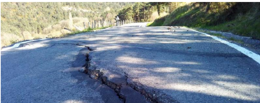
Figura 24. Deslizamientos en carretera a Errea (municipio de Esteribar). Image: David Gómez Urrutia (Arista Arquitectos), arquitecto asesor del municipio
