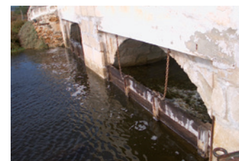
Sistema de compuertas en la Albufera des Grau (Mahón).
