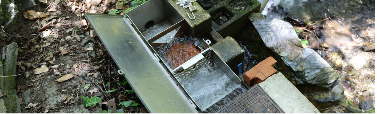
Dispositivo para una mejor gestión del agua en las captaciones, que permite asegurar un caudal ecológico en el torrente.
